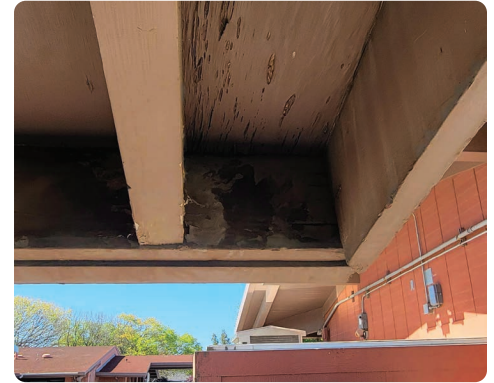
El tejado deteriorado en la escuela Primaria Burchfield
